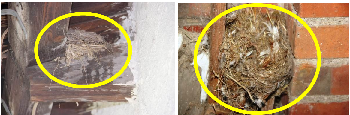
Bsp. Nester von Kleinvögeln in Dachbereichen und Mauernischen
